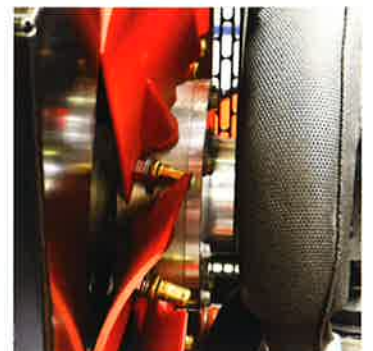
réversion de ventilateur
