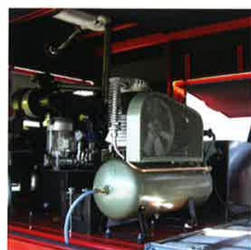
compresseur pour le nettoyage
